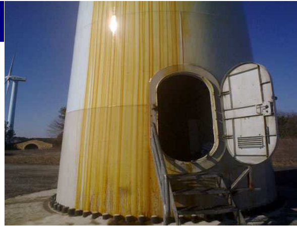
Uno de los vertidos de aceite en la central eólica de El Perdón
