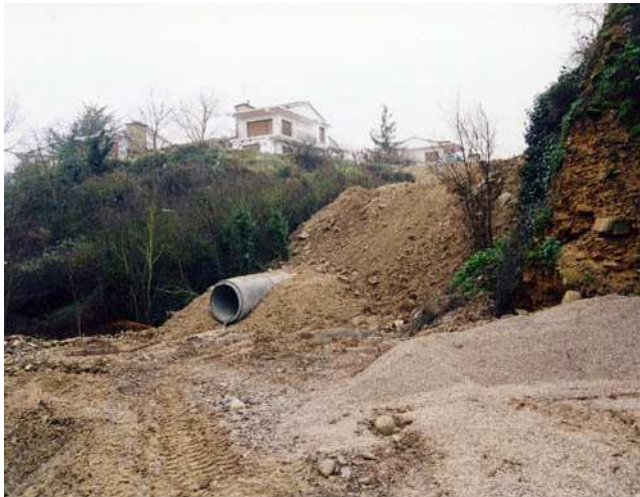
Barranco de San Blas en Cáseda utilizado como vertedero de tierras y restos de obras. Desde su ejecución se han producido las afecciones denunciadas por Gurelur en el año 2004.
